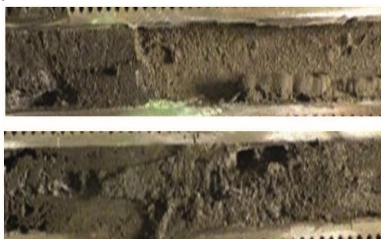
Figura 3. Tubos do permutador de calor bloqueados devido à acumulação de depósitos elevados
